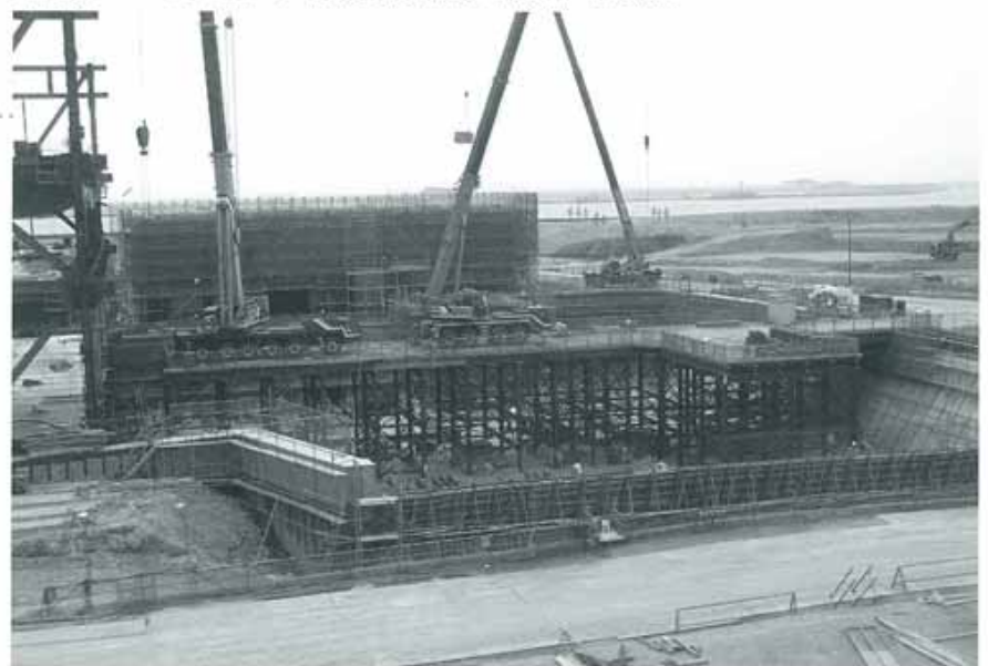
次世代スーパーコンピューター施設建設地写真(2009年2月撮影)
